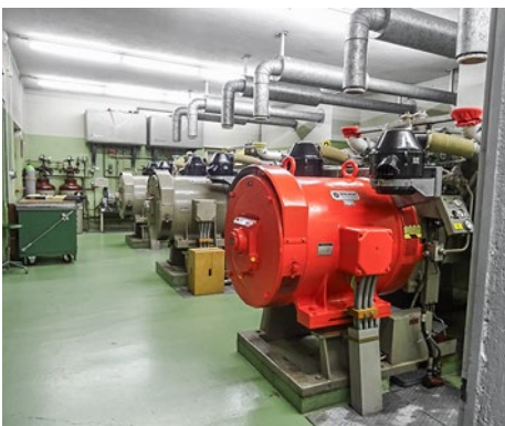
Unterirdische Anlage: Autonome Stromversorgung
